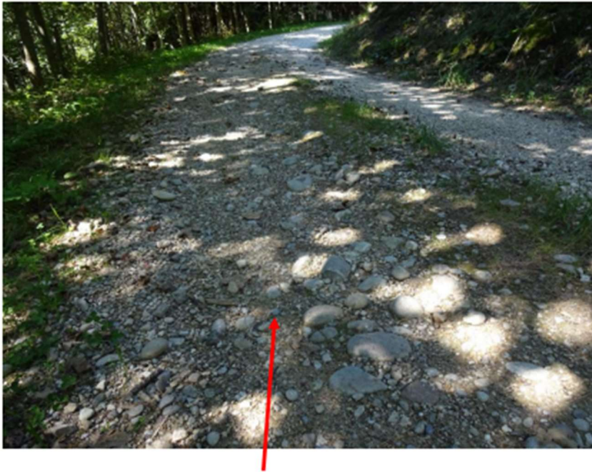
Mergelschicht fehlt komplett und die Strassenfundation (Kofferung) fehlt teilweise auch
