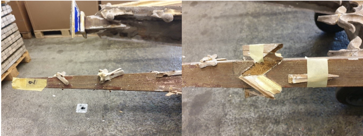
Abb. 22-23: Fotoaufnahmen in der Lagerhalle vom August 2019; Fehlende, abgebrochene oder lose Bausubstanzen erkennbar. Restaurierung der Fiale zur Erhaltung der historischen Substanzen deutlich notwendig.
