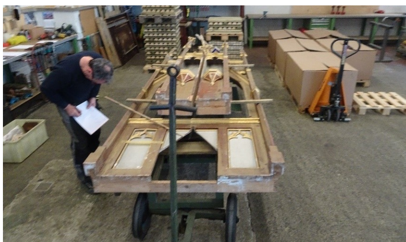
Abb. 25-27: Besichtigung und Zustandserfassung des Hochaltars durch Restaurator Holzwerk und Restaurator Oberflächen in der Lagerhalle.
